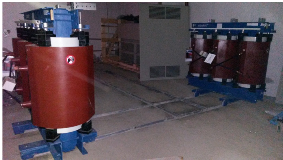
Şekil 5.7: İstasyon 3 ( Etiler İstasyonu ) 34,5/0,4kV 1000 kVA Kuru Tip İç İhtiyaç Trafoları
