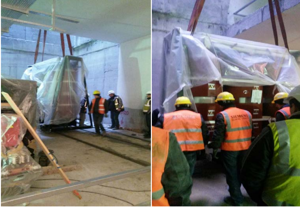
Şekil 5.3: İstasyon 4 (Boğaziçi Üni. ) CER Trafosu
