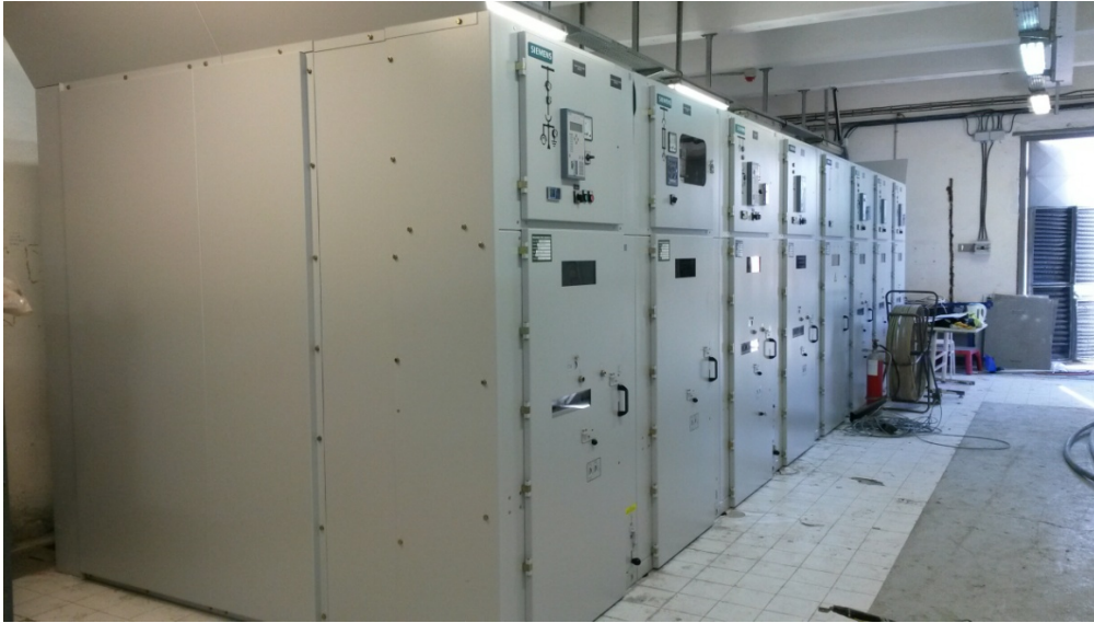
Şekil 5.2: Levent-Hisarüstü Metro Hattı Orta Gerilim Hücreleri
