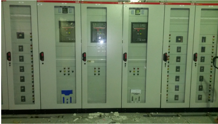
Şekil 5.8: İstasyon 4 ( Boğaziçi Üniversitesi İstasyonu )Ana Dağıtım Panoları
